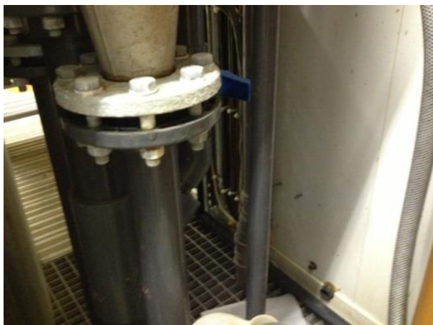
Figur 12 Detalj av løsfrens med korrosjonsskade
