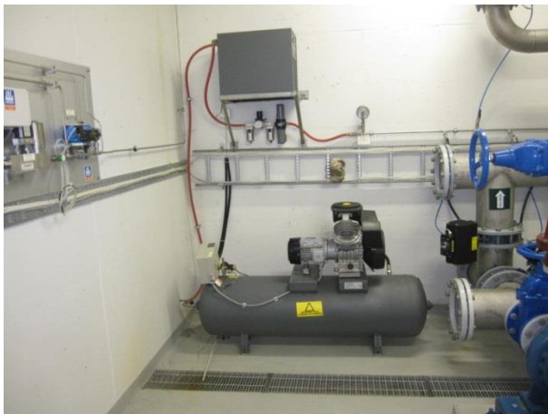
Figur 4 Kompressor og kjøletørke
