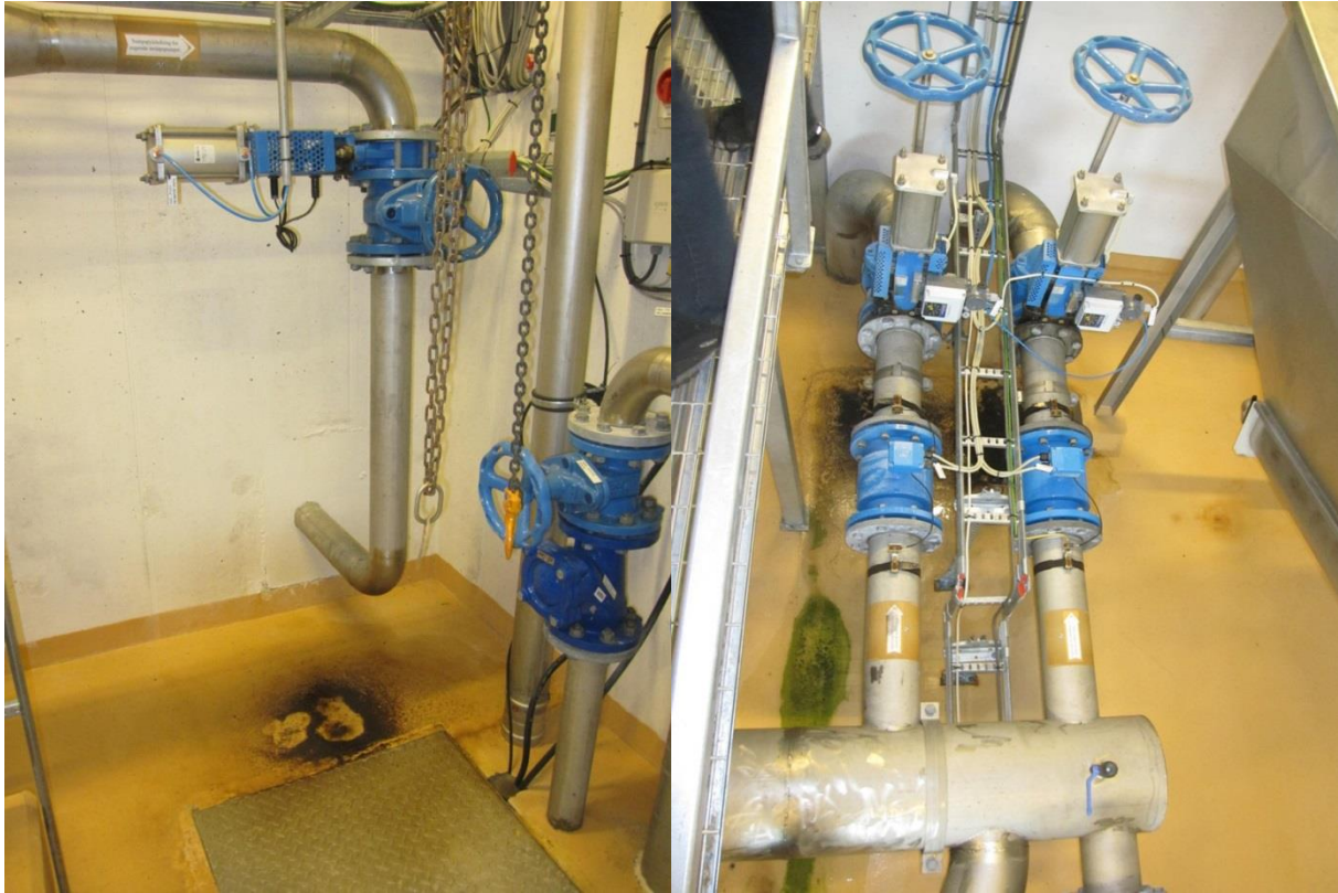
Figur 6 Eksempler på lekkasje fra ventiler
