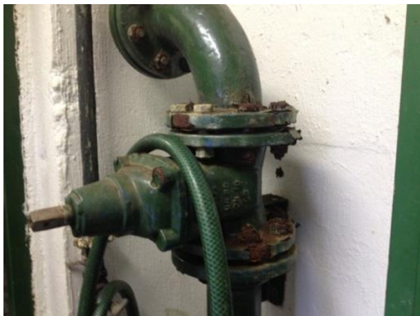
Figur 21 Detalj av korrosjon på rør og bolter
