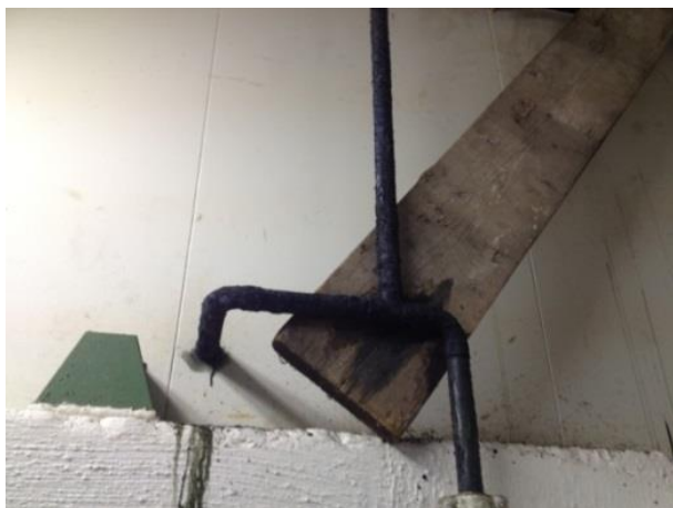
Figur 22 Detalj H 2 S korrosjon på vannrør i kobber
