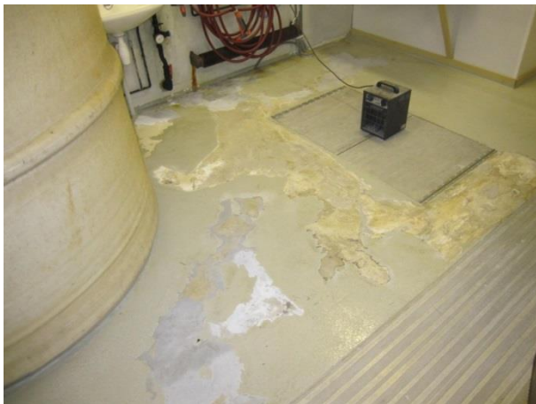
Figur 17 Skader på epoksybelegg
