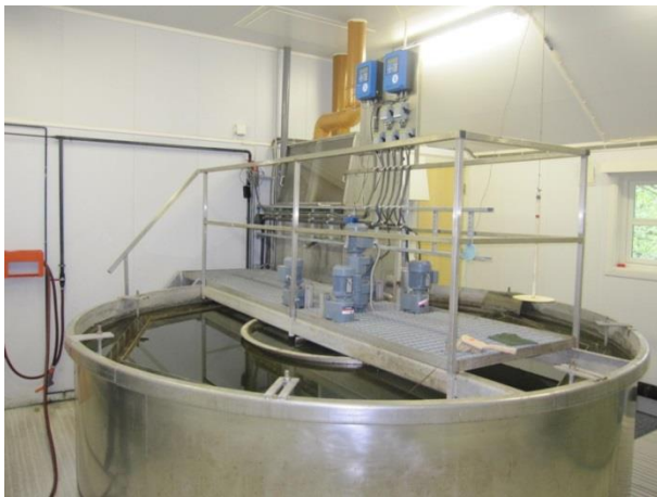
Figur 10 Tank for flokkulering og sedimentering
