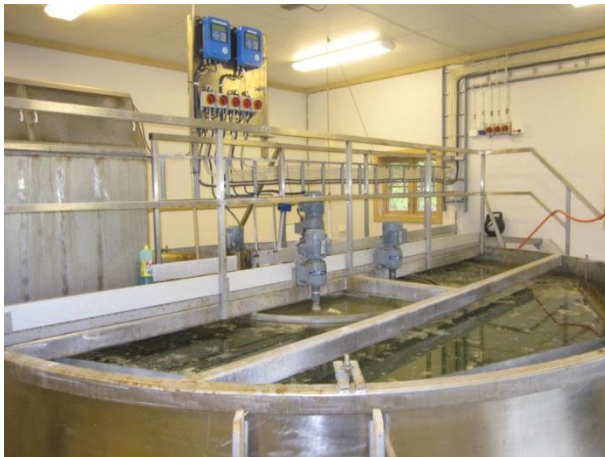
Figur 14 Tank for flokkulering og sedimentering
