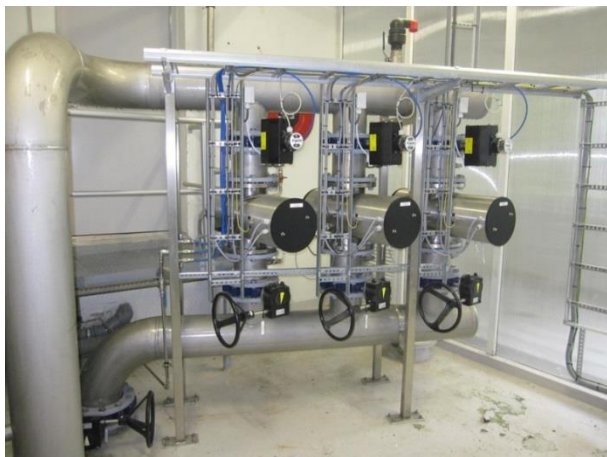
Figur 1 UV-installasjonen på Bossvika VBA
