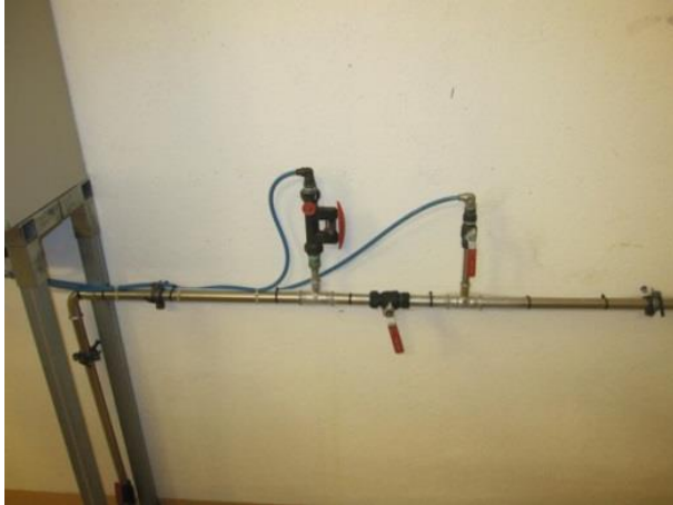
Figur 7 H 2 S korrosjon på messing ventiler
